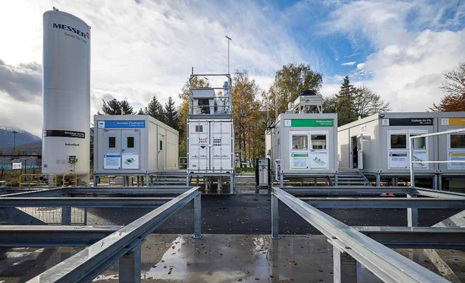
Figure 1 : Centre de contrôle et de surveillance (CSA) à Aigle (VD)
